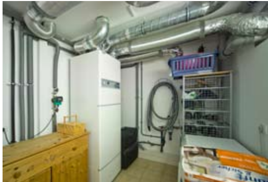
Funktional ist das Gäste-WC gestaltet (rechts), übersichtlich die Haustechnik im Wirtschaftsraum (links).
